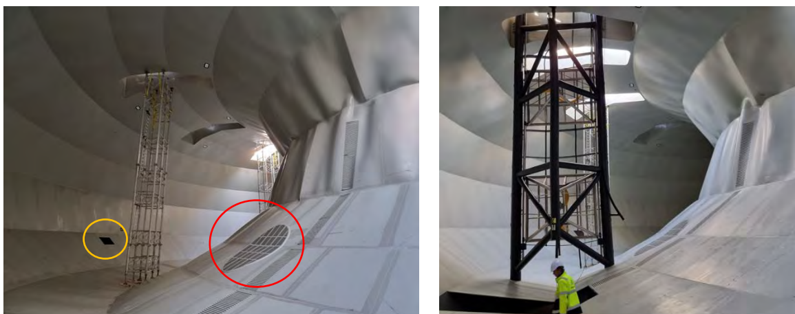
Figur 1 Venstre bilde: Fiskevolum; inn- og utløpsrør. Høyre bilde: Strømsettertårn med 2 stk. Xylem miksere
